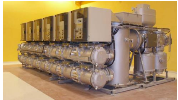
Cabinas AT SE El Portillo
