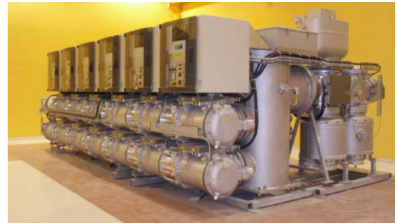
HV Cabins of ES El Portillo
